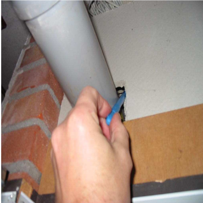
Doorvoeringen niet afgedicht
