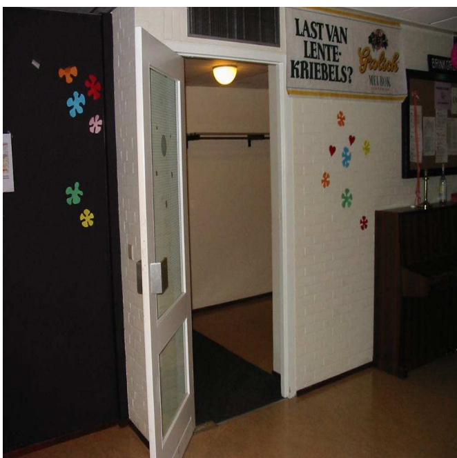
Deur niet brandwerend / niet zelfsluitend
